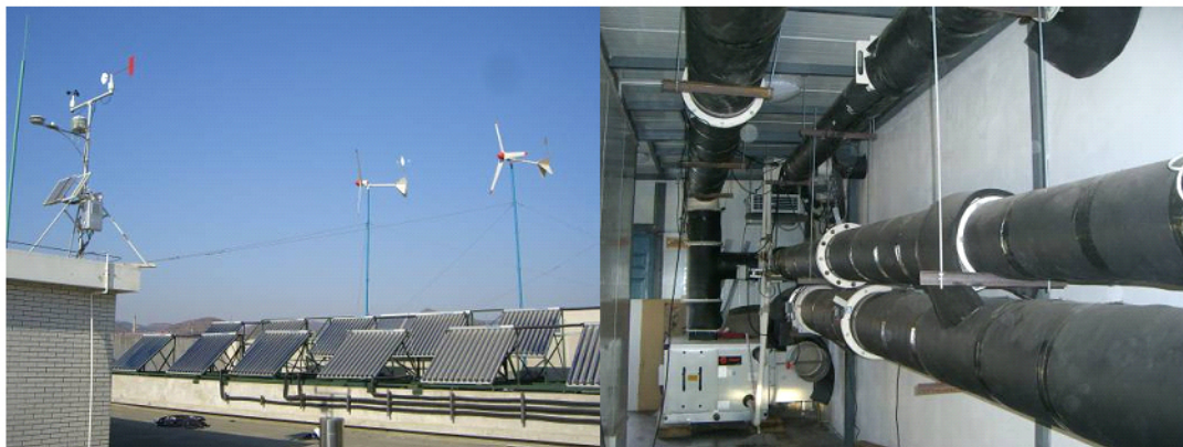
太阳能集热器阵列中央空调风系统与空调机组
