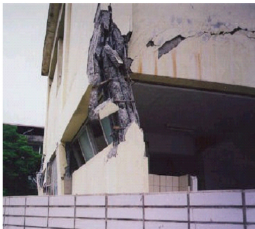
校舍结构柱破坏
