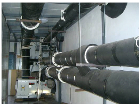
太阳能集热器阵列中央空调风系统与空调机组
